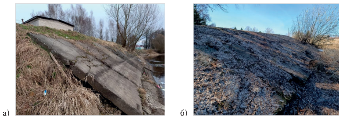
Рис. 2. Комплекс берегоукреплений на реках Согожа и Пертомка, г. Пошехонье, Ярославская область: а) — аварийно-опасный участок; б) — участок удовлетворительного состояния
